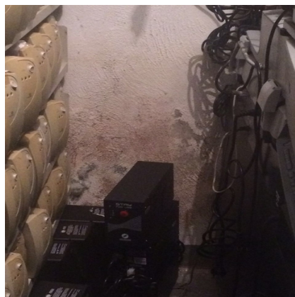
Figura 24: Umidade no Depósito de Equipamentos
