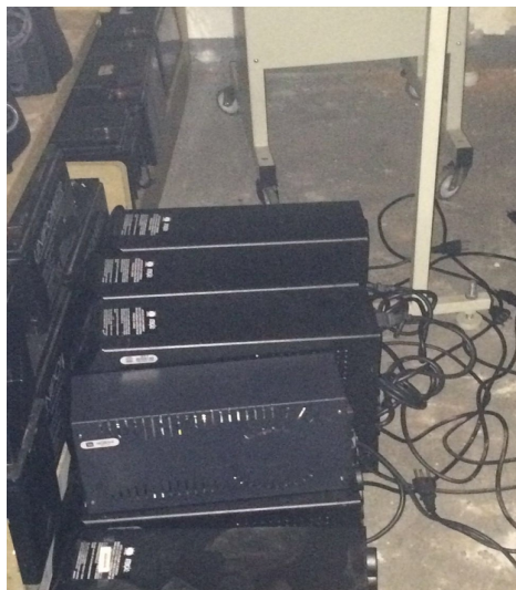
Figura 21: Nobreaks em contato direto com o piso
