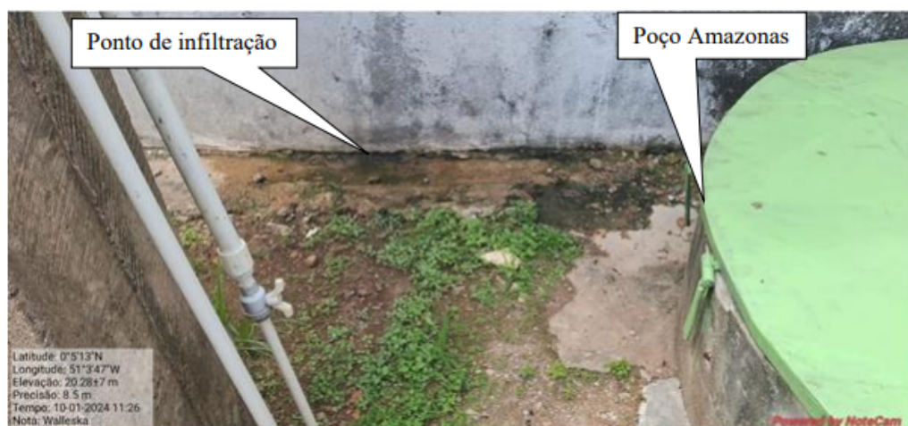
Figura 01: Ponto de infiltração no muro que limita os dois imóveis e ao lado, em verde, o poço Amazonas.
