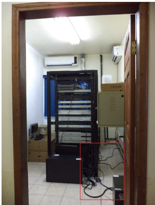
Visão da entrada: cabos dispersos pelo chão.
