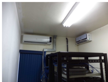
Vista dos ares-condicionados.
