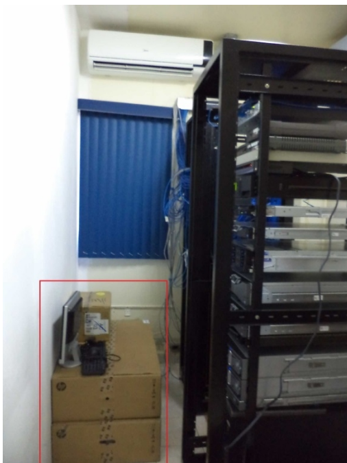
Visão lateral da estante de equipamentos: material combustível.
