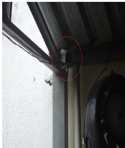
Monitoramento do acesso secundário 01. Destaque para a câmera de monitoramento.
