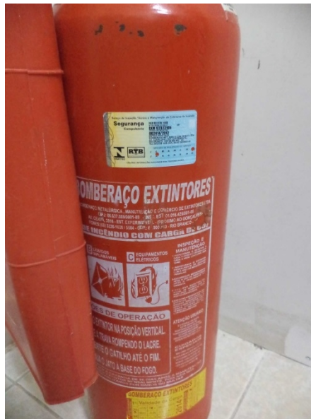
Extintor de incêndio.
