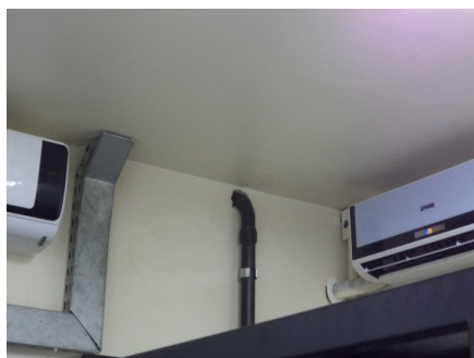
Detalhe dos ares-condicionados.
