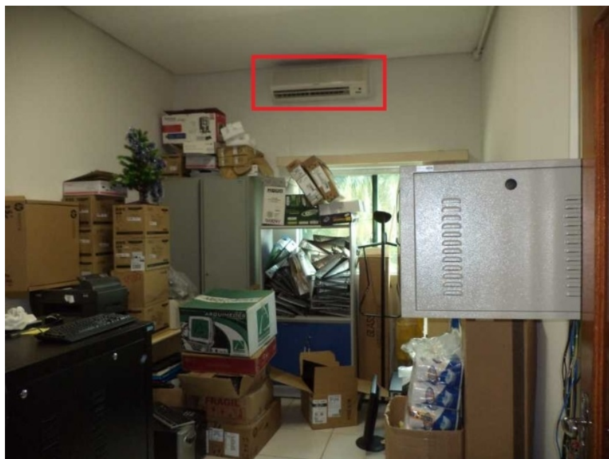
Figura 1.3 – Sistema de refrigeração
