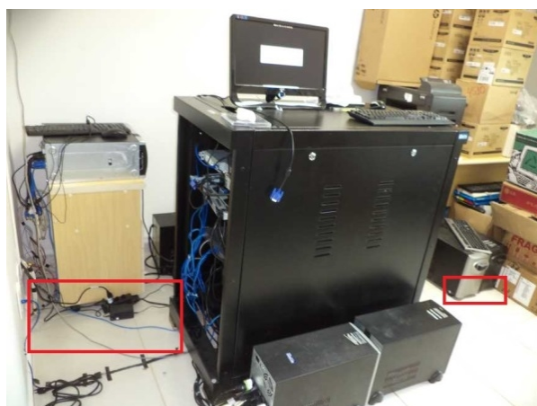
Visão lateral da estante de equipamentos ( Rack ). Destaque para equipamento no nível do piso e desorganização de cabeamento.
