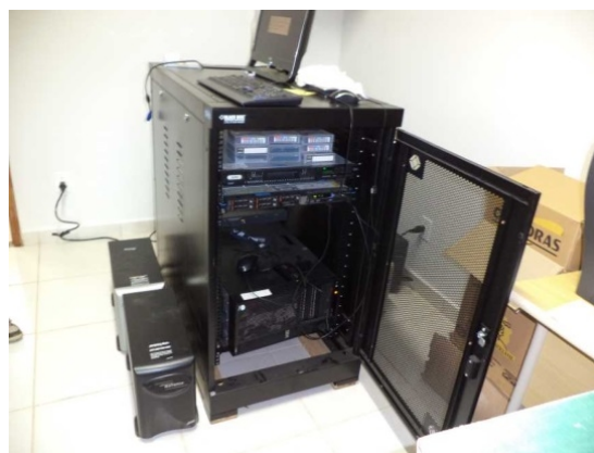
Visão frontal da estante de equipamentos ( Rack ).
