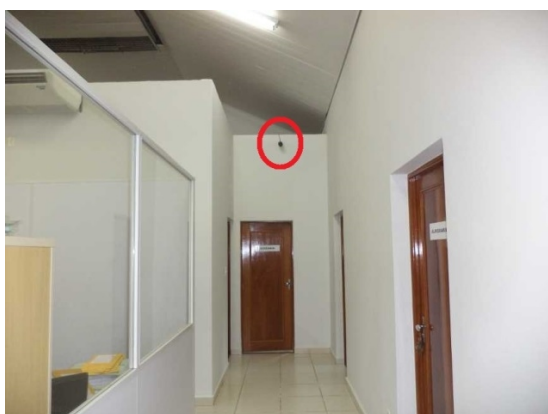
Corredor de acesso ao CPD. Destaque para câmera de monitoramento.
