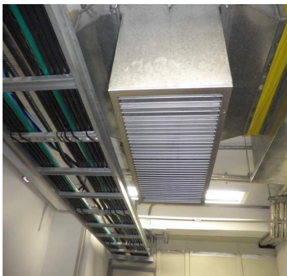
Ar condicionado sala contígua.
