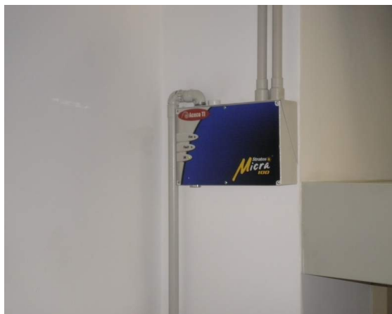
Sistema de combate a incêndio (sala contígua)
