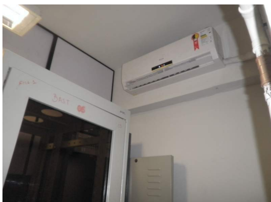
Ar condicionado central telefônica.
