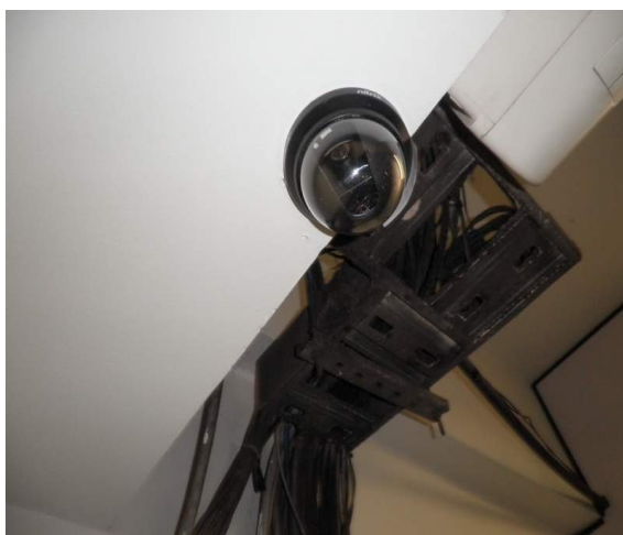
Câmera interna - Sala de Telecomunicações
