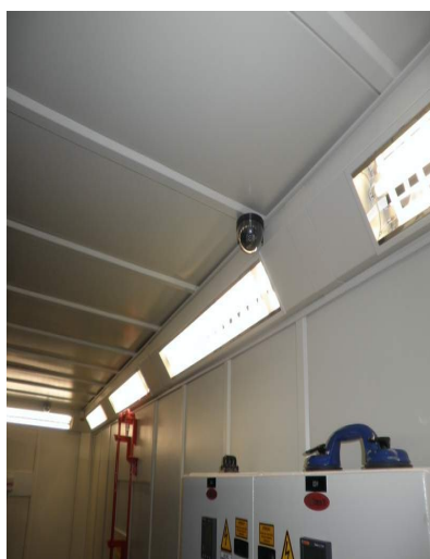
sensor de incêndio
