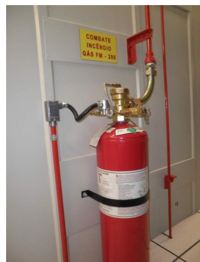
sistema de combate ao incêndio
