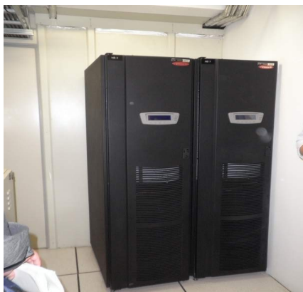
Nobreaks - sala contígua
