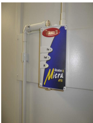
sensor / alarme de incêndio
