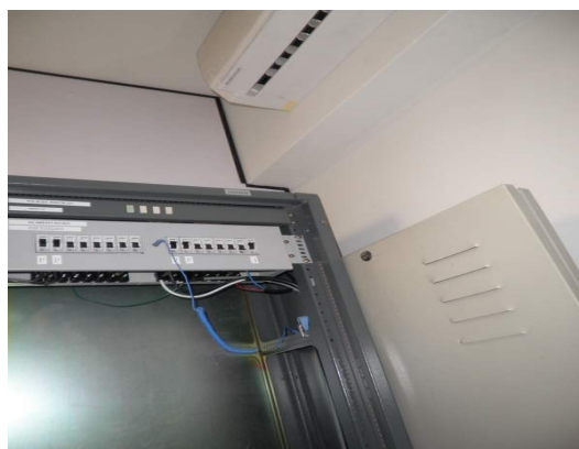
Ar condicionado central telefônica.
