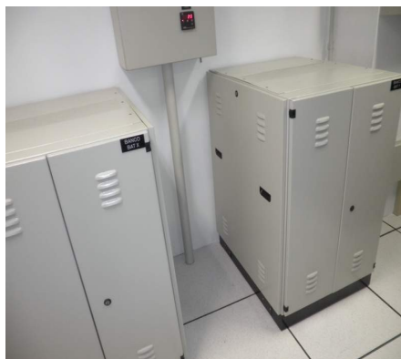
bateria dos nobreaks - sala contígua
