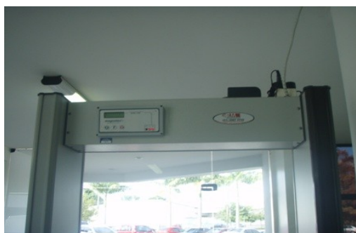
Pórtico de detecção de metais.
