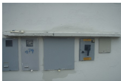
PTM BOA VISTA: DETALHES DO QUADRO ELÉTRICO
