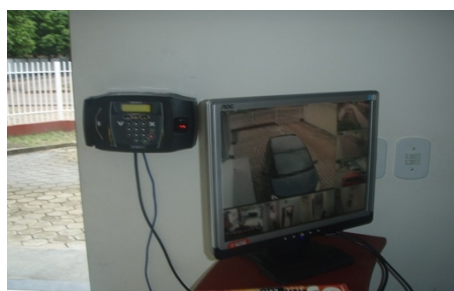
PTM BOA VISTA: VISTA DO MONITOR DE CFTV
