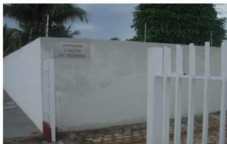
PTM BOA VISTA: PORTÃO DA GARAGEM SEM SINALIZADOR
