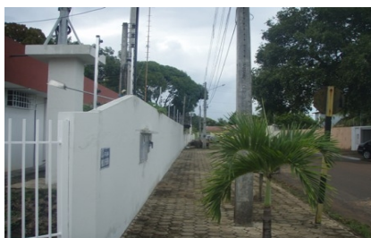
PTM BOA VISTA: VISÃO PANORÂMICA DO QUADRO ELÉTRICO
