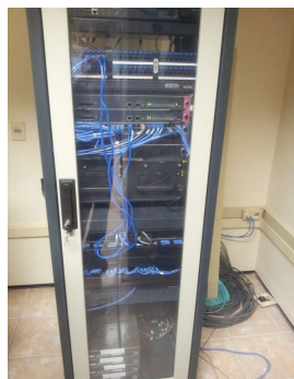
Estante (Rack) de equipamentos.
