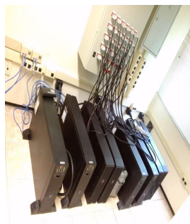
Computador servidor: equipamento no nível do piso.
