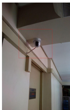
Monitoramento do acesso ao CPD
