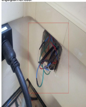
Visão de parede adjacente ao quadro de energia. Fiação exposta.
