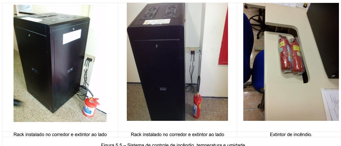
Figura 5.5 – Sistema de controle de incêndio, temperatura e umidade.
