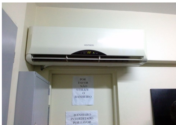
Vista do ar-condicionado Figura 5.3 – Sistema de refrigeração
