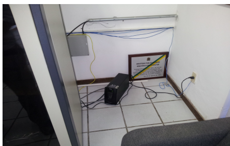
Foto 1 – no-break para os equipamentos instalados no rack.
