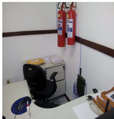
Foto 3 – Extintores próximos aos equipamentos de TI.
