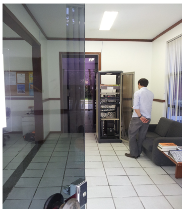
Foto 2 – rack instalado próximo à porta de vidro de entrada do prédio.
