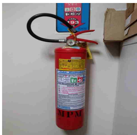
Extintor de incêndio. Sistema de controle anti-incêndio.
