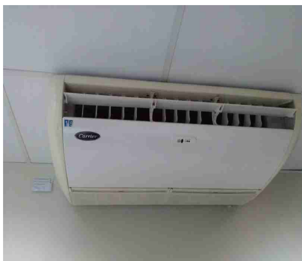
Sistema de refrigeração. Vista do ar-condicionado
