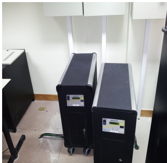
Foto 2 – Nobreaks dos servidores do CPD.
