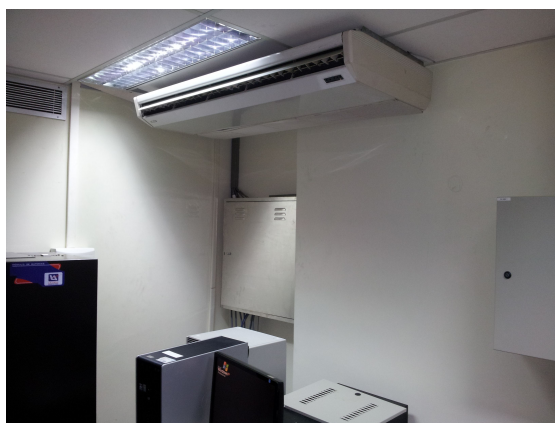
Foto 4 – Ar-condicionado do CPD próximo a equipamento eletrônicos.
