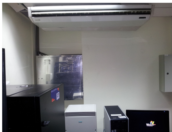
Foto 5 – Ar-condicionado do CPD próximo a equipamento eletrônicos.
