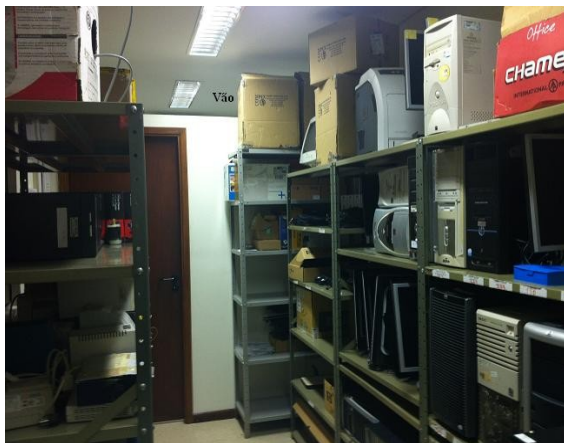
Sala Técnica com o vão e a porta de acesso ao CPD
