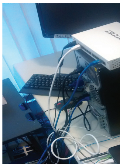
Ilustração 10: Equipamentos de TI em prédio locado
