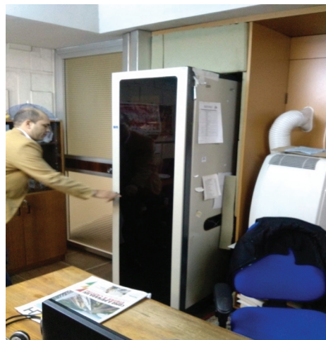
Ilustração 13: Rack de distribuição
