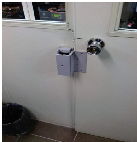
Ilustração 7: Controle de acesso à sala do CPD
