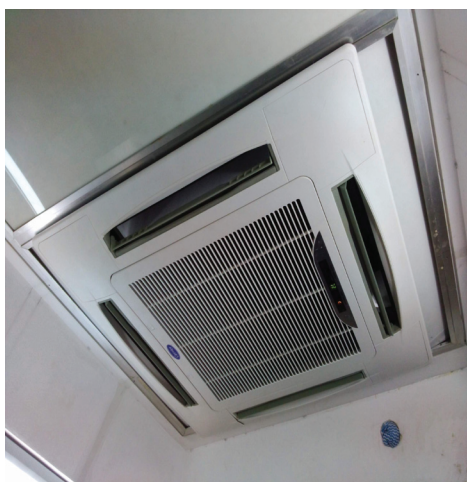
Ilustração 10: Ar-condicionado do CPD
