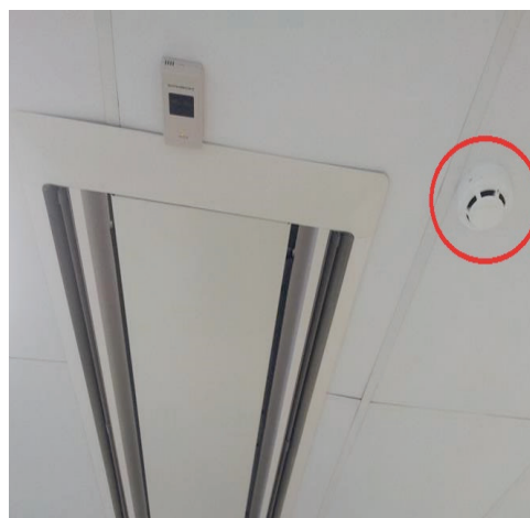
Ar Condicionado e sensor de fumaça
