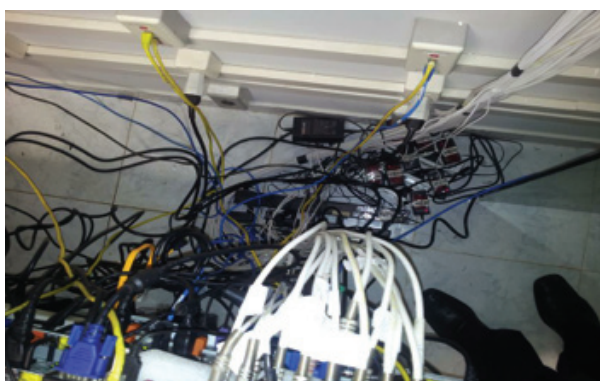
Ilustração 25: Cabejamento dos equipamentos do CPD
