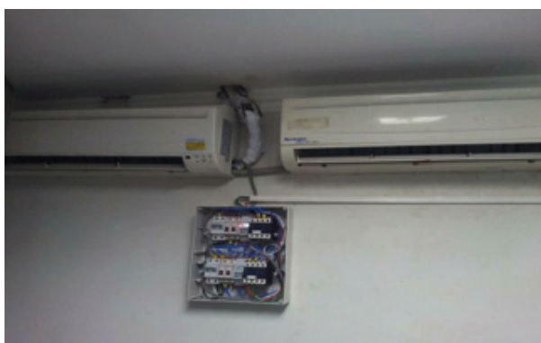
Ilustração 26: Ar condicionado no CPD
