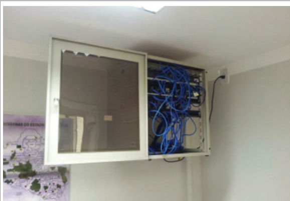
Ilustração 28: Rack que acomoda equipamentos da rede
