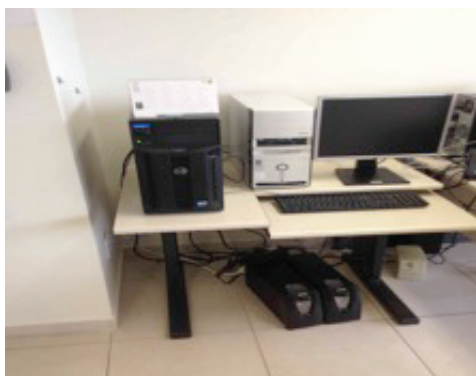
Computador-servidor onde é feito o backup
