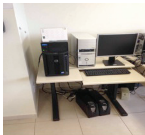
Computador-servidor onde é feito o backup
