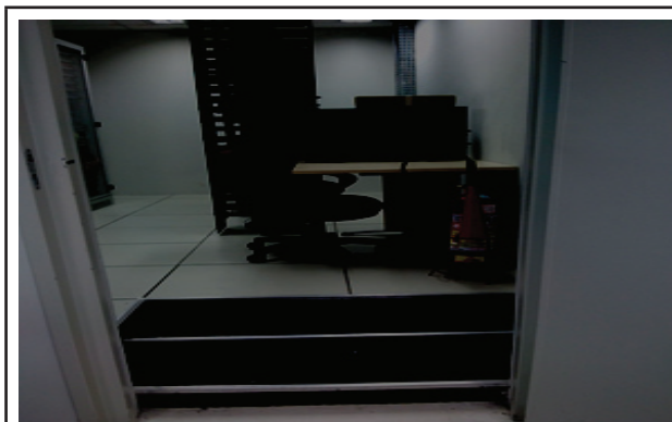
Piso elevado do CPD.
