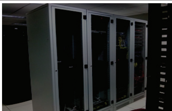
Organização interna do CPD, estantes com equipamentos – Racks.
