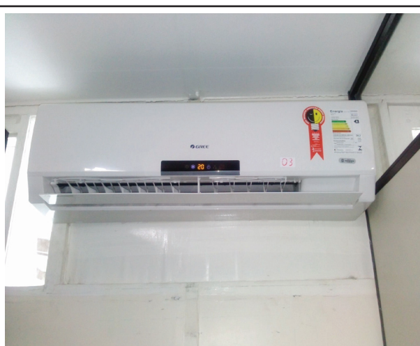
Ilustração 18: Ar-condicionado do CPD
