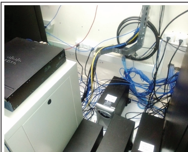
Ilustração 15: Cabelamento dos equipamentos de CPD
