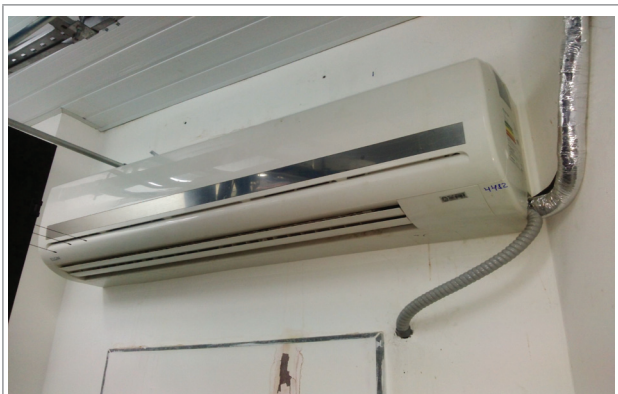
Ilustração 12: Ar-condicionado do CPD
