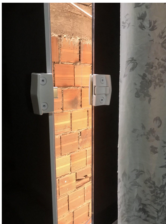
Janela arrombada do segundo andar.
