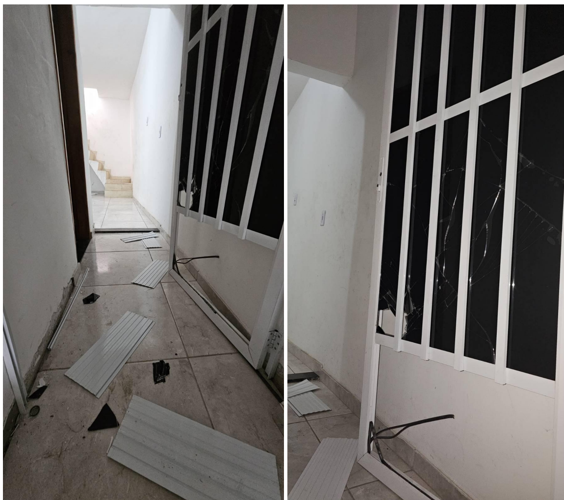
Foto 1 e 2: Porta da residência destruída.
