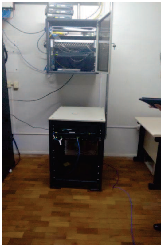
Parte do cabeamento não organizado
