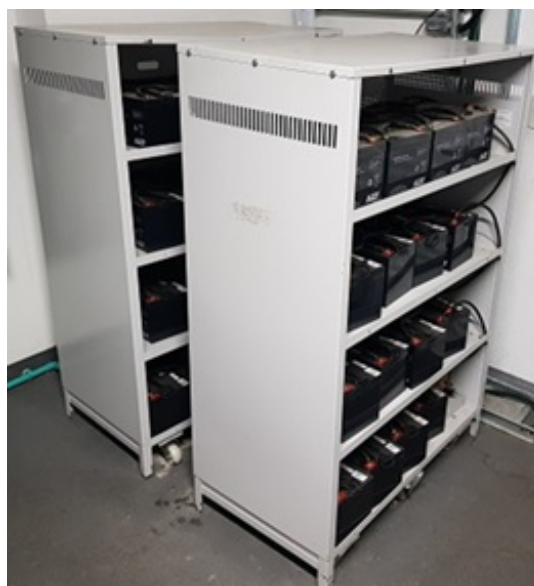
Foto 3: Dois bancos de baterias do No-break com as tampas abertas para visualização das baterias
