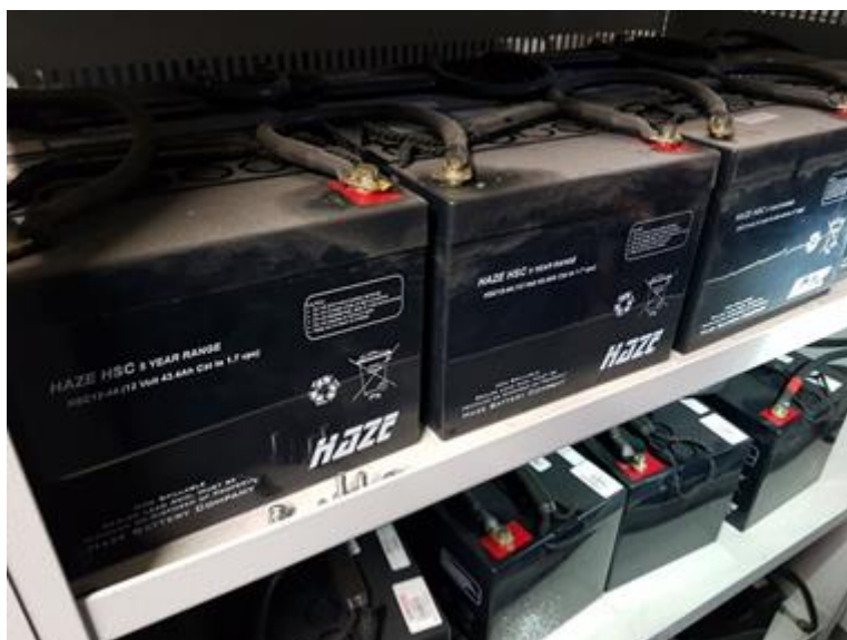
Foto 04: Detalhe das baterias que integram um dos bancos de baterias
