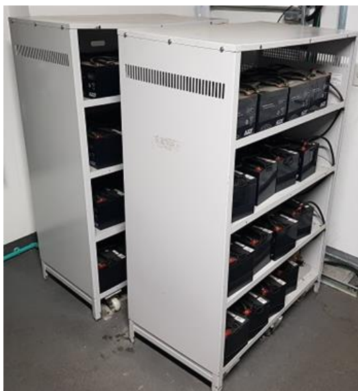
Foto 03: Dois bancos de baterias do No-break com as tampas abertas para visualização das baterias
