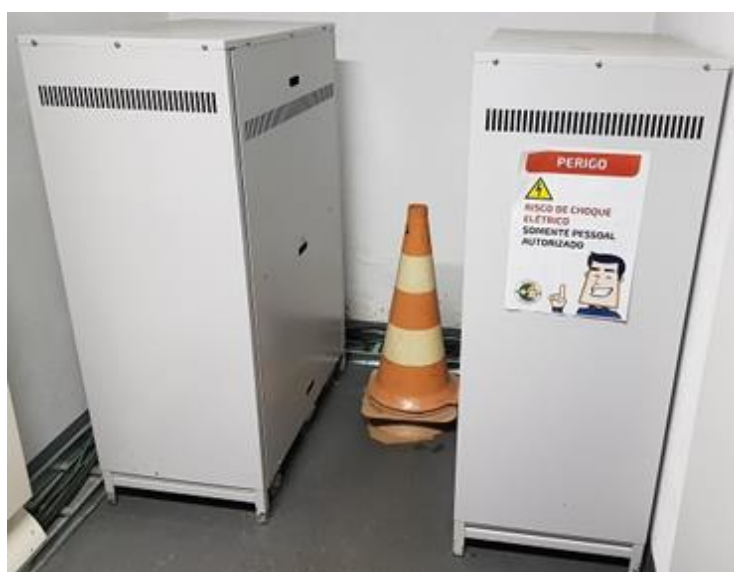
Foto 02: Visualização dos dois bancos de baterias do No-break.
