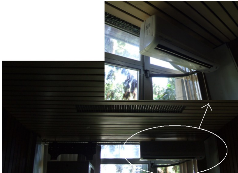
figura 3 – sistema de refrigeração do datacenter
