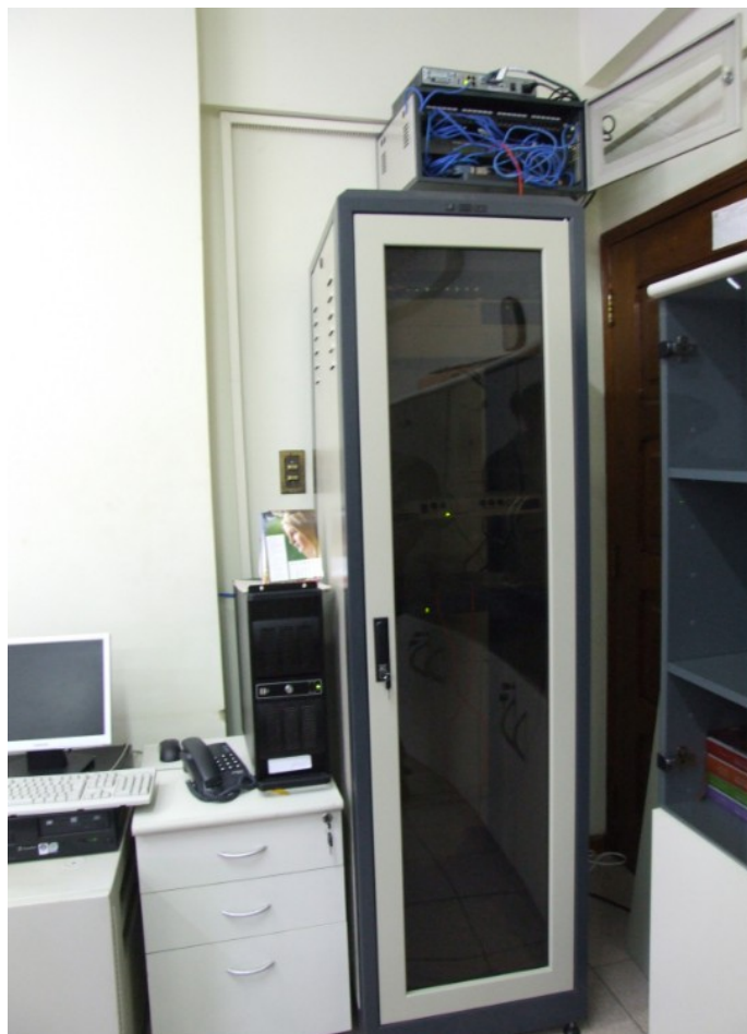
Servidores de rede e equipamentos de comunicação
