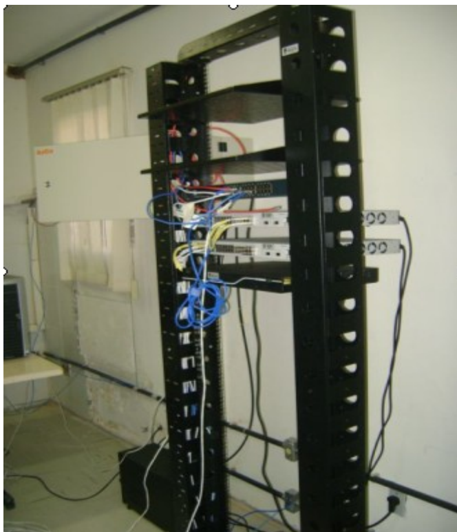
Fotografia 07 - Rack com os ativos de rede no CPD.
