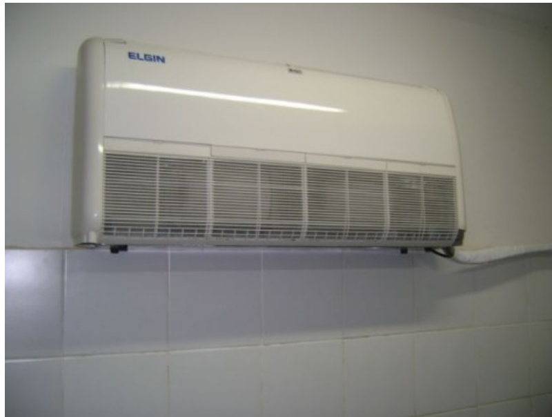
Fotografia 04 - Ar condicionado split do CPD
