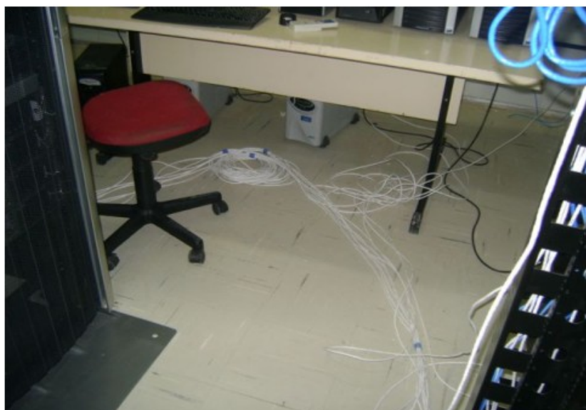
Fotografia 06 - Fios soltos no chão dentro do CPD
