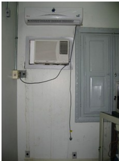
Fotografia 09 – Detalhe das paredes e ar condicionado do CPD
