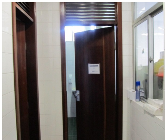
Figura 4. Banheiros sem adaptação para pessoas com deficiência
