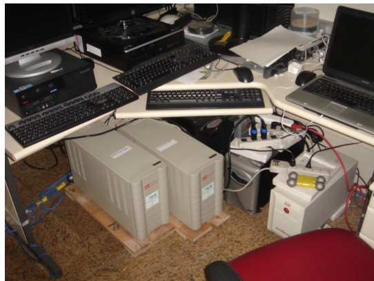
Acomodação deficiente de equipamentos
