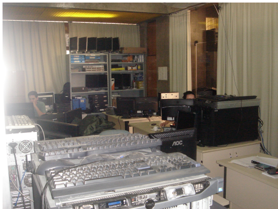
Equipamentos amontoados sobre outros e espaço apertado para acomodação e trânsito dos servidores.
