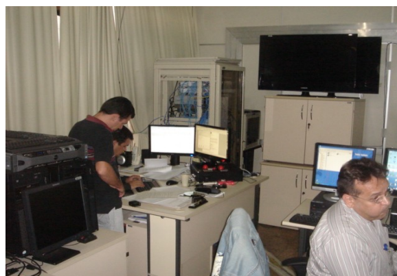
Rack dos servidores e switchs ao fundo
