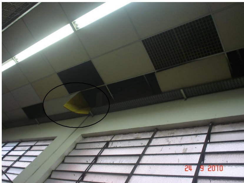
figura 18 – Teto do Almojarifado do MPSP (Casa Verde)
