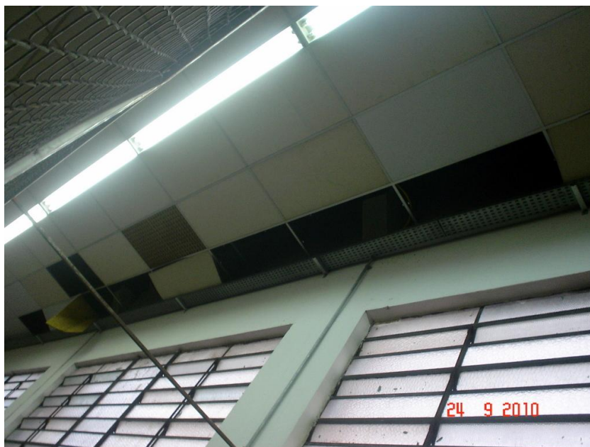
figura 17 – Teto do Almojarifado do MPSP (Casa Verde)
