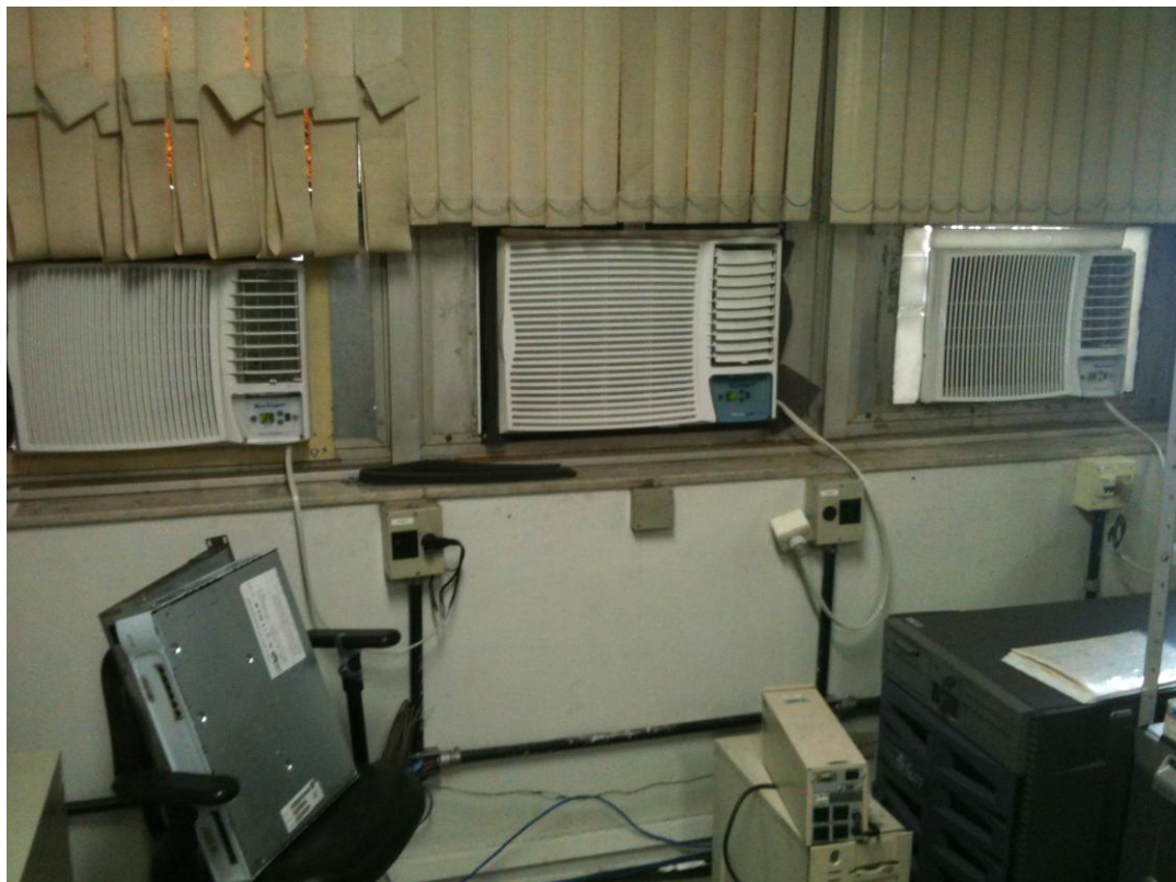
Foto – Aparelhos de ar-condicionado na sala no CPD do prédio localizado no n. 768
